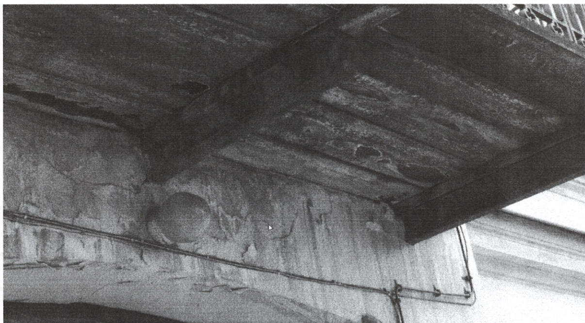
Fotografia 7. Uszkodzenia tynku w rejonie balkonu. Elementy stalowe skorodowane. Korozja biologiczna podłogi balkonu.
