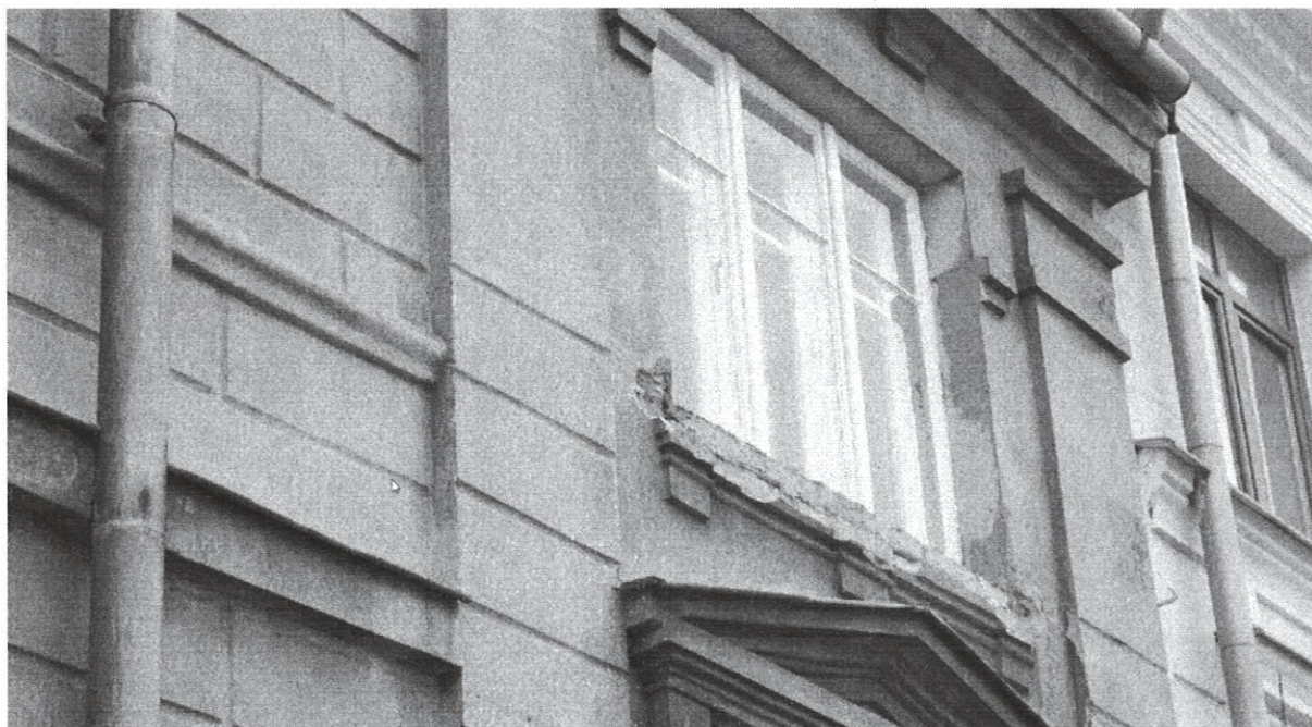
Fotografia 13. Uszkodzenia tynku w rejonie otworu okiennego – brak parapetu.
