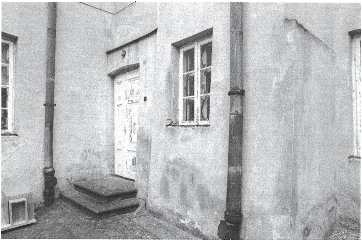
Fotografia 39. Destrukcja tynku w rejonie przyziemia. Brak parapetów zewnętrznych przy oknach.
