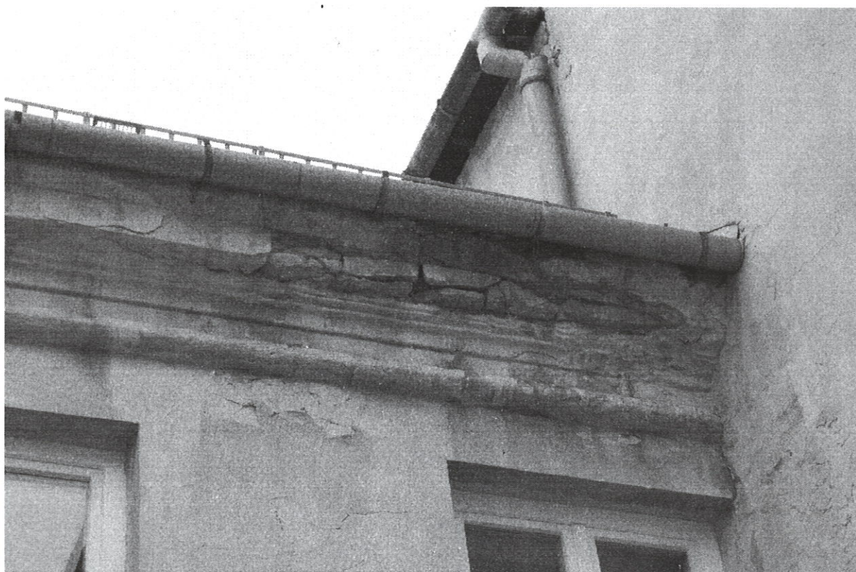
Fotografia 35. Uszkodzenia gzymsu i ściany przy rynnie.
