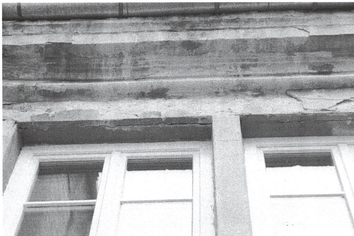
Fotografia 30. Odspojenie tynku nad otworami okiennymi – spowodowane zawilgoceniem gzymsu na skutek nieszczelności rynien.
