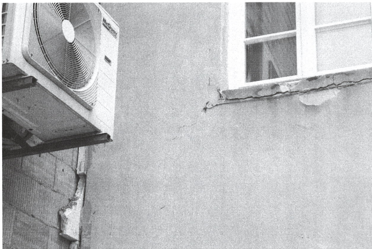
Fotografia 23. Zarysowanie ukośne przy otworze okiennym – nierównomierne osiadanie budynku;
