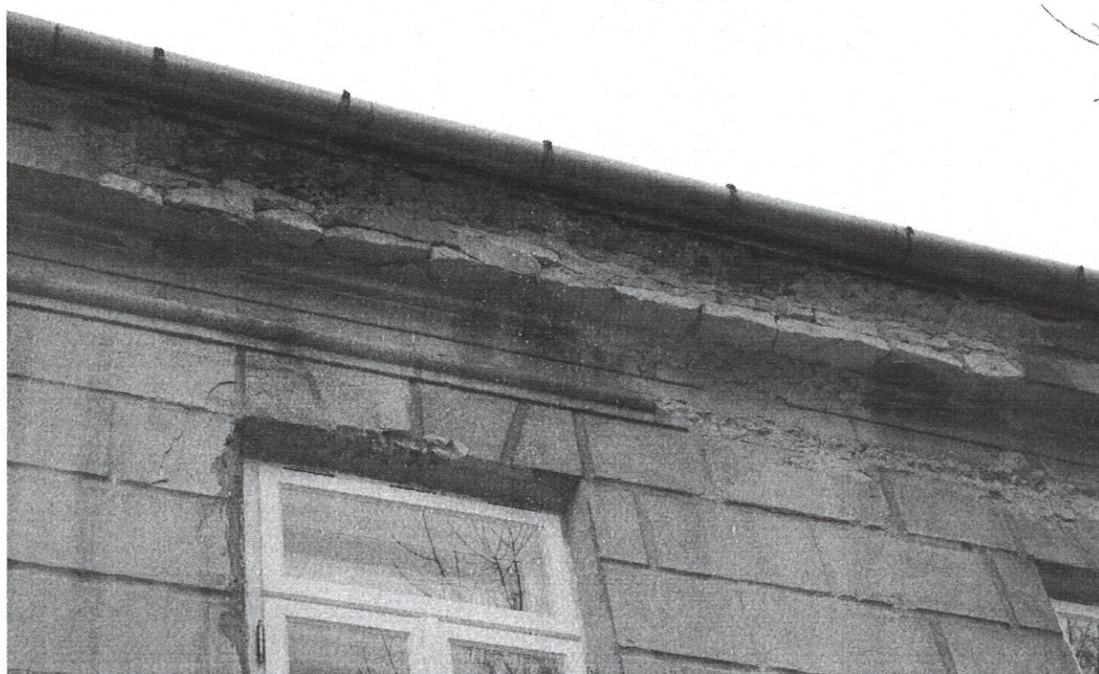
Fotografia 14. Ubytki tynku w rejonie gzymsu – nieszczelności obróbek blacharskich.
