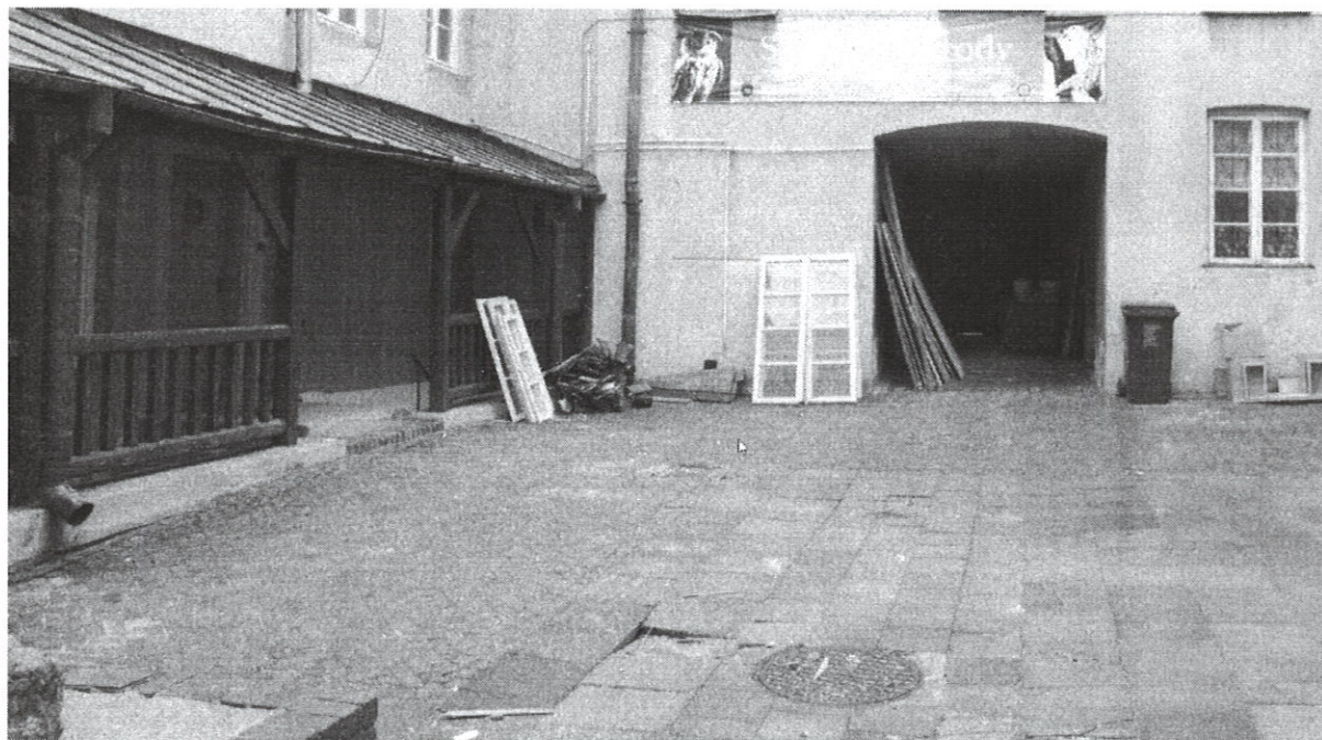
Fotografia 48. Zapadnięty fragment utwardzenia dziedzińca w rejonie studzienki kanalizacji deszczowej.
