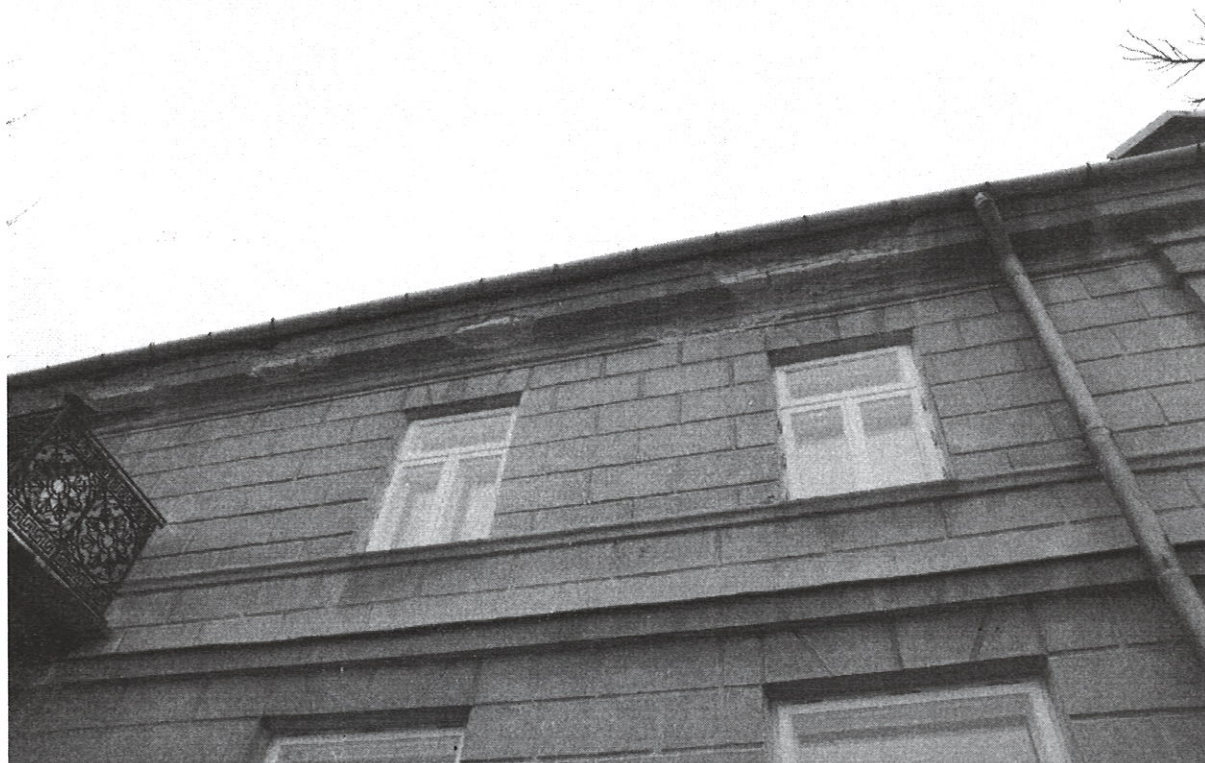
Fotografia 18. Ubytki tynku w rejonie gzymsu – nieszczelności obróbek blacharskich.
