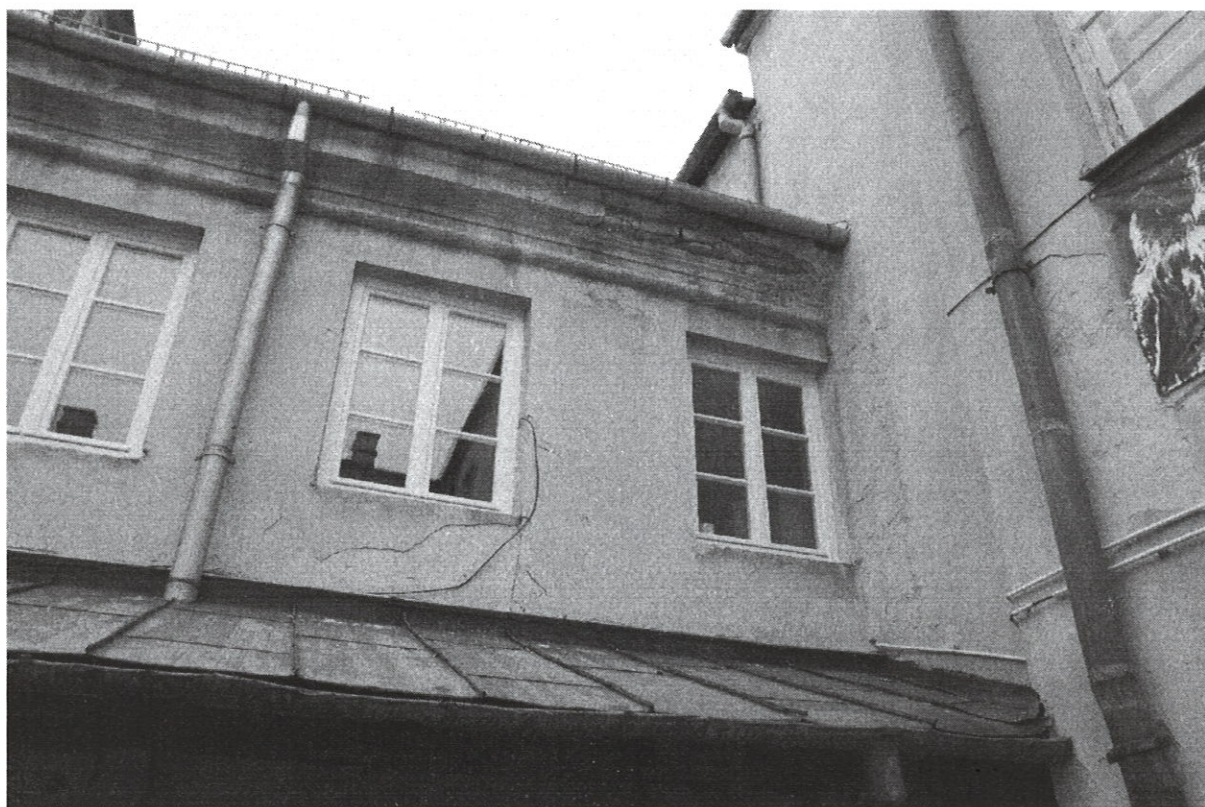
Fotografia 34. Uszkodzenia gzymsu i ściany przy rynnie i rurze spustowej.
