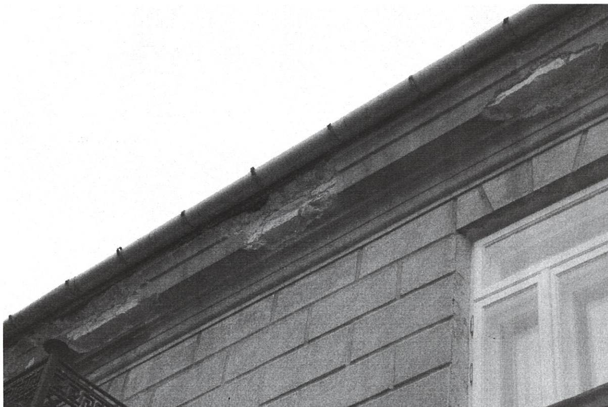
Fotografia 17. Ubytki tynku w rejonie gzymsu – nieszczelności obróbek blacharskich.
