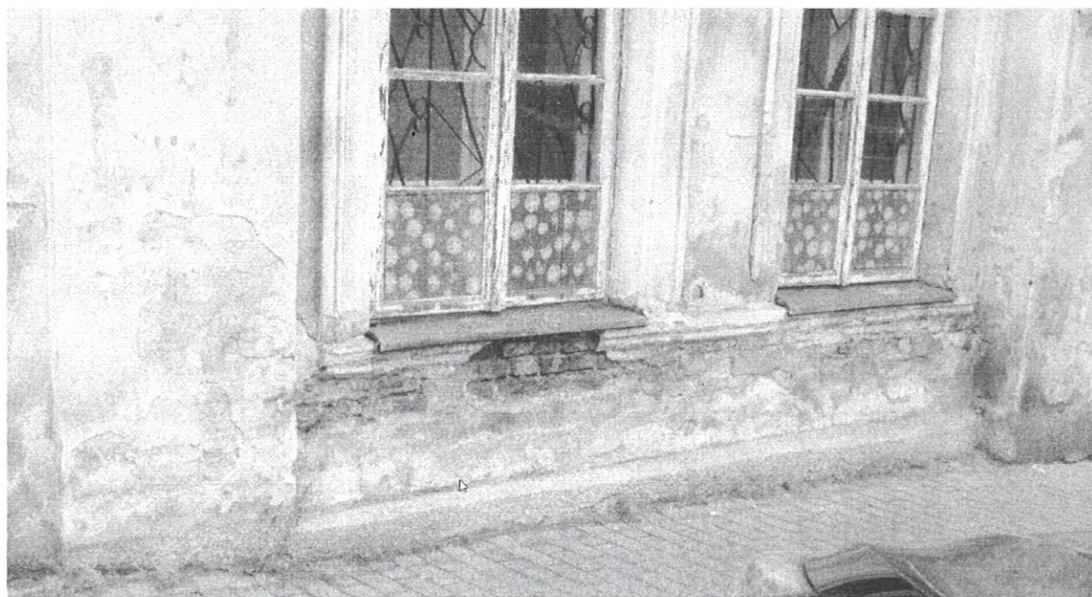
Fotografia 8. Uszkodzenia tynku w dolnym rejonie otworów okiennych. Destrukcja tynku pilastrów – rysy skurczowe, zawilgocenie, zasolenie.
