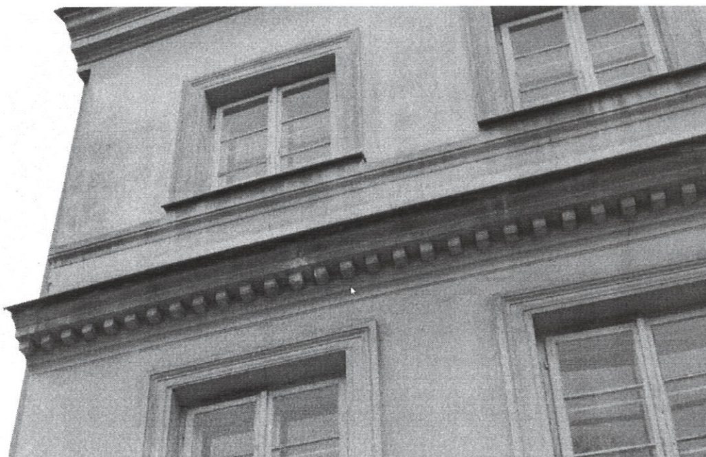
Fotografia 9. Zarysowania przy otworze okiennym – nierównomierne osiadanie budynku;
