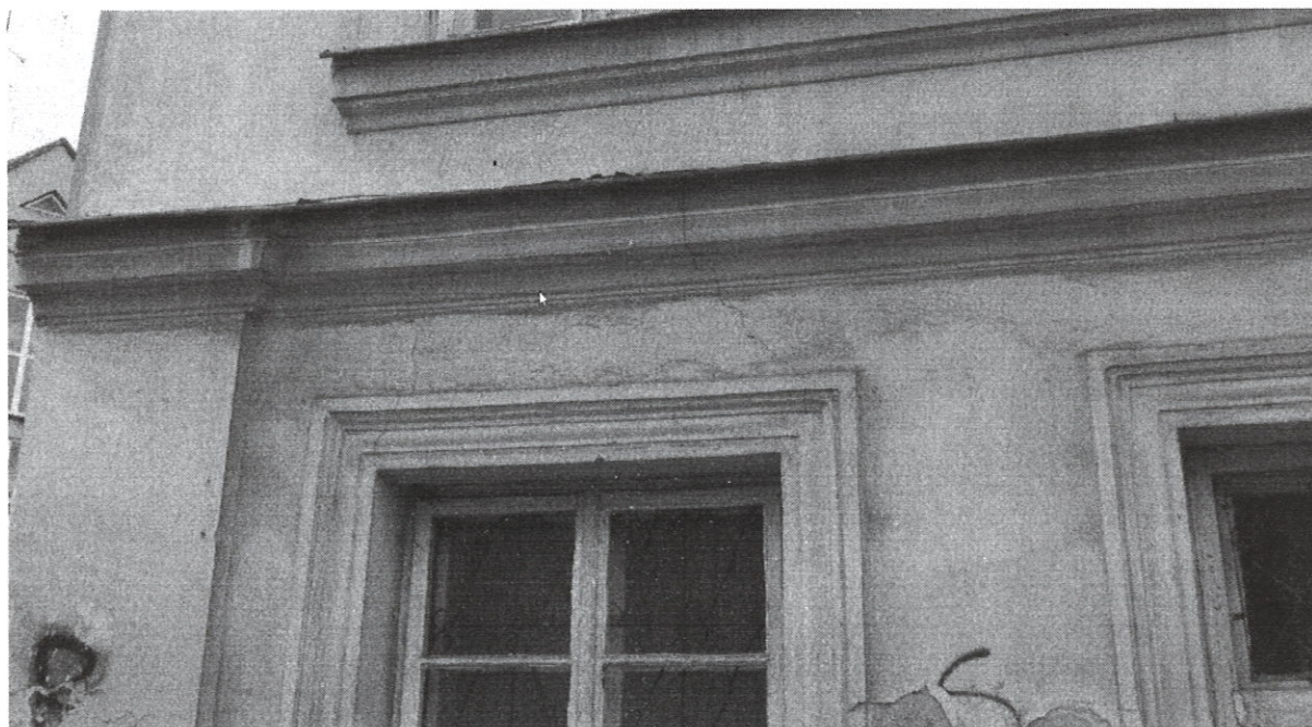
Fotografia 10. Zarysowania przy otworze okiennym – nierównomierne osiadanie budynku;
