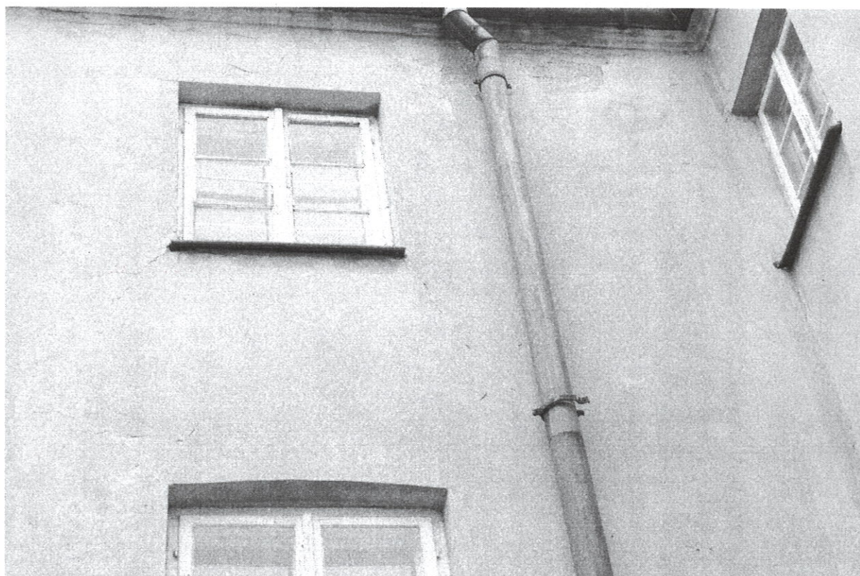
Fotografia 45. Zarysowania w rejonie otworów okiennych oraz destrukcja tynku gzymsów przy rynnach.
