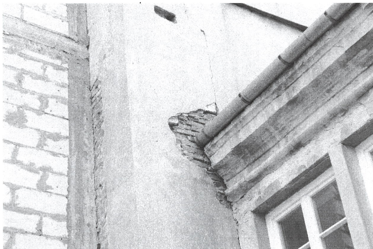
Fotografia 27. Ubytki tynku w rejonie rynny.
