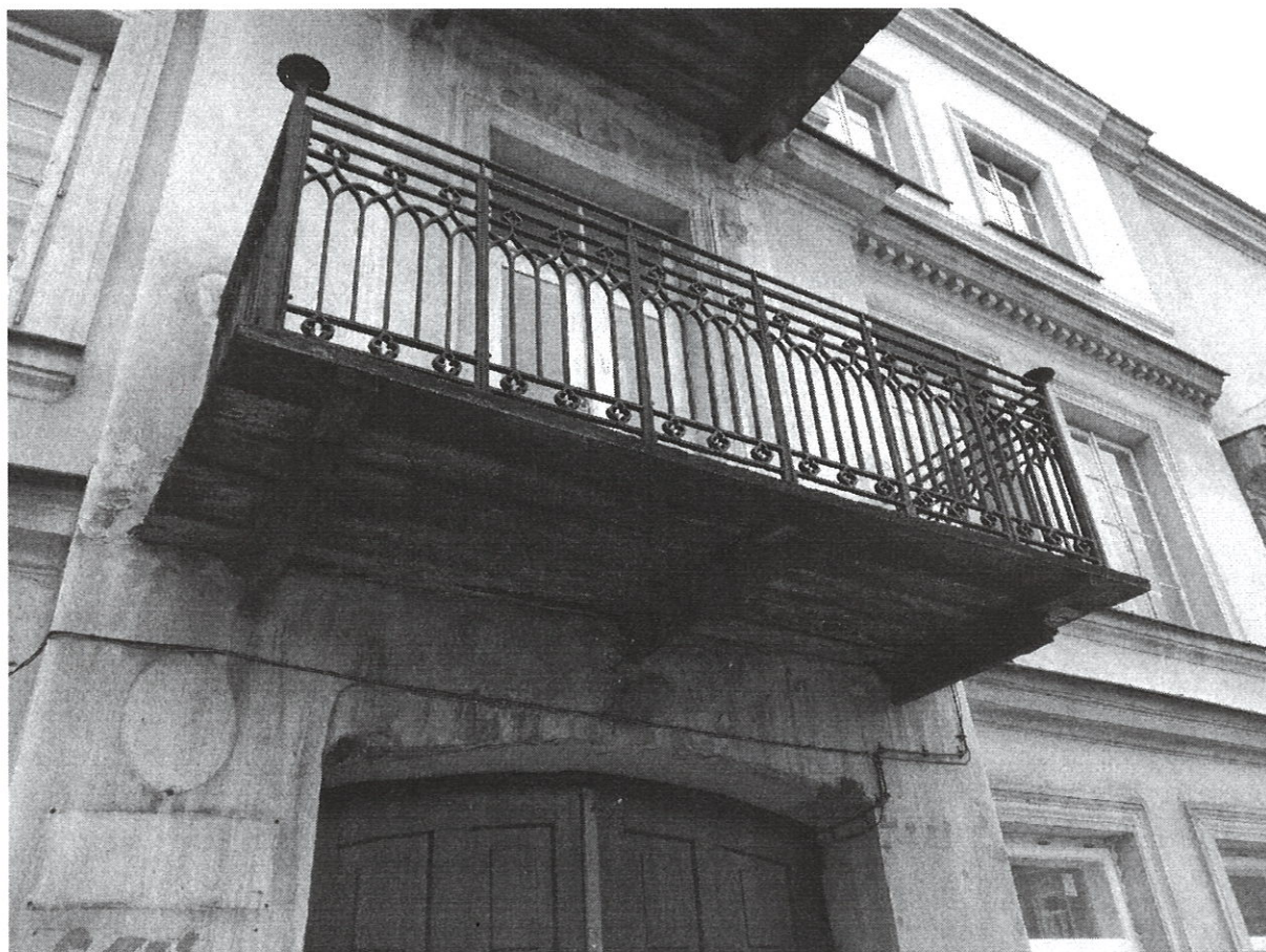
Fotografia 5. Uszkodzenia tynku w rejonie balkonu. Elementy stalowe skorodowane. Korozja biologiczna podłogi balkonu.
