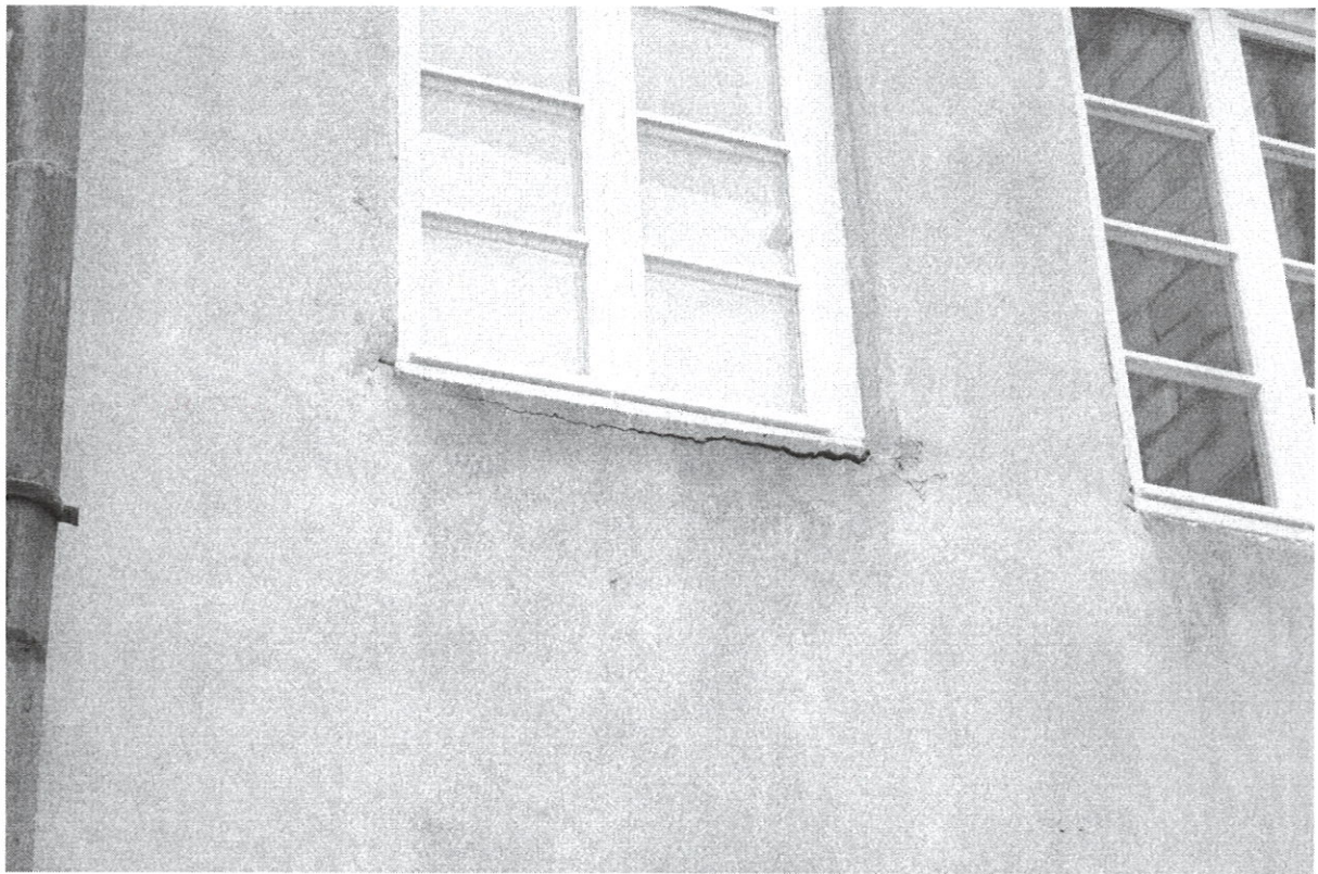
Fotografia 38. Uszkodzenie tynku w dolnej partii otworu okiennego – brak parapetów.
