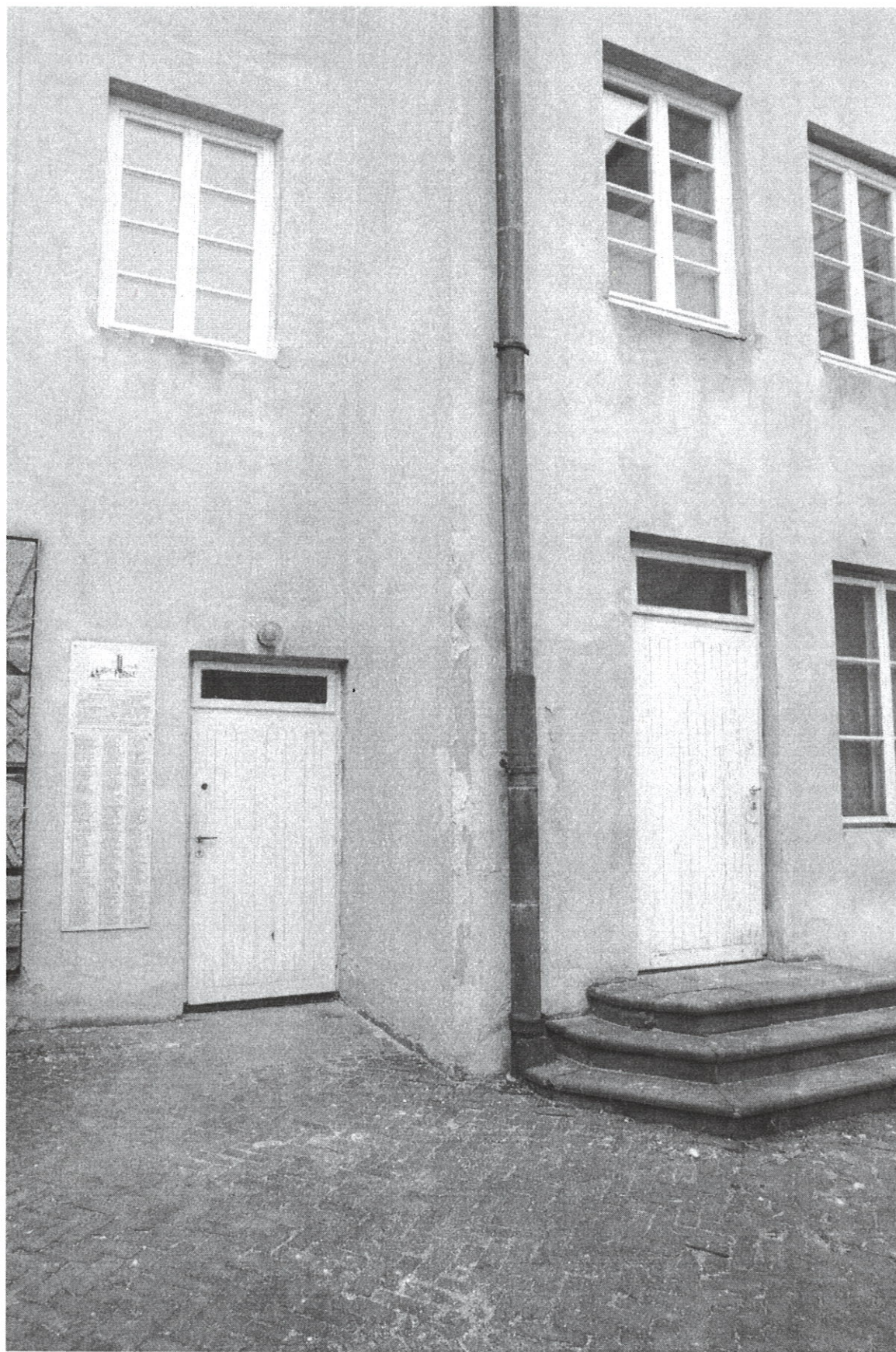
Fotografia 40. Uszkodzenia tynku w rejonie przyziemia oraz przy rurze spustowej.
