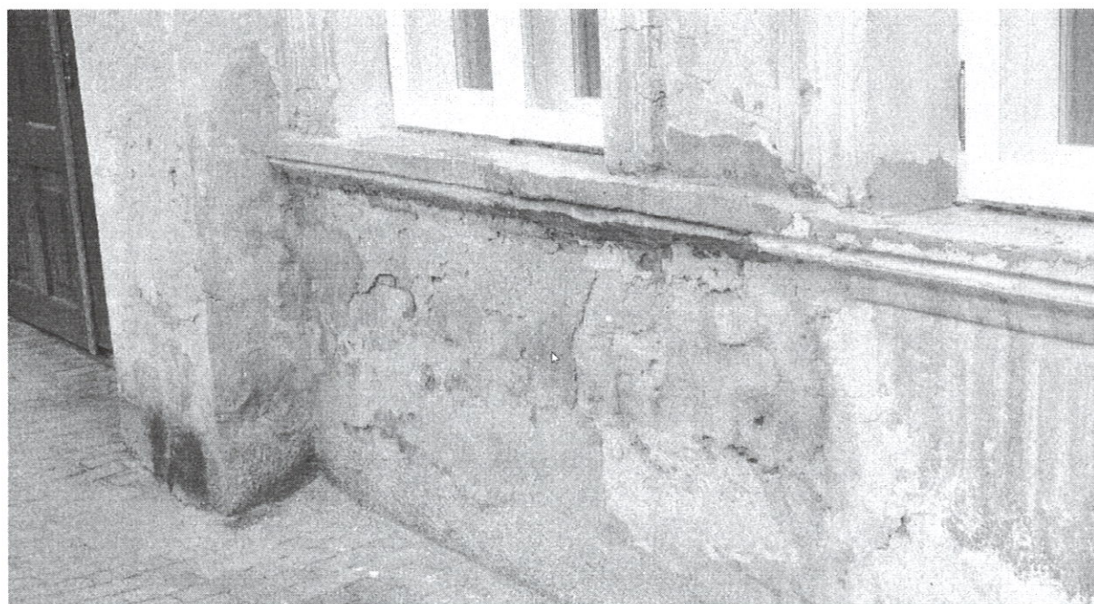
Fotografia 4. Uszkodzenia tynku w rejonie przyziemia spowodowane zawilgoceniem i zasoleniem.
