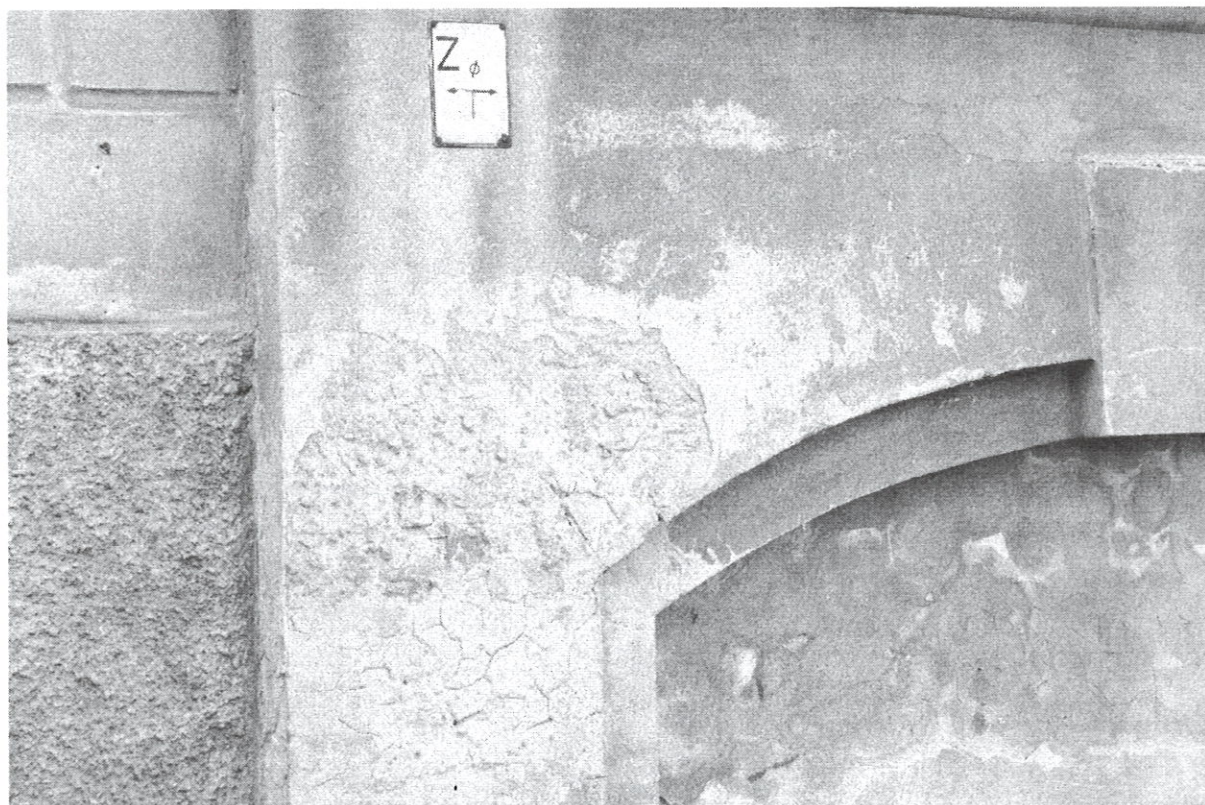
Fotografia 15. Rysy skurczowe tynku. Widoczne ślady zawilgocenia i zasolenia.
