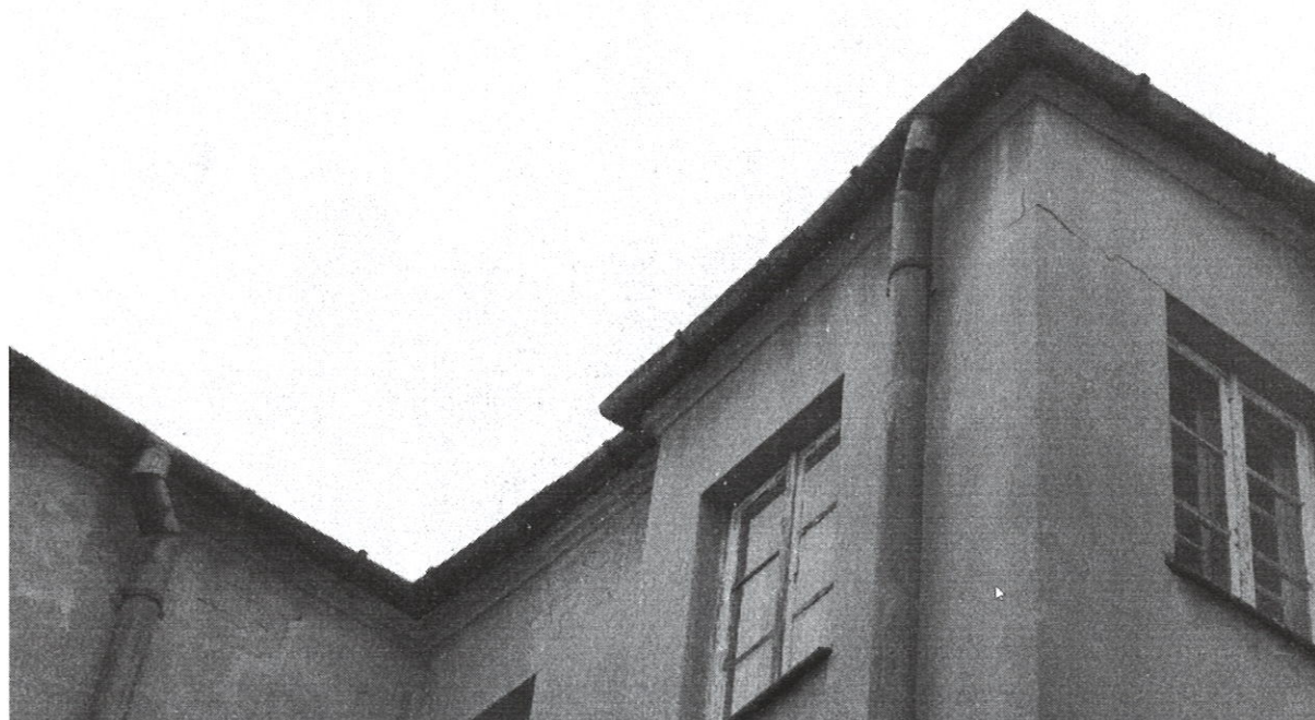
Fotografia 42. Zarysowanie poziome narożnika oraz destrukcja tynku w rejonie gzymsów i rynien.
