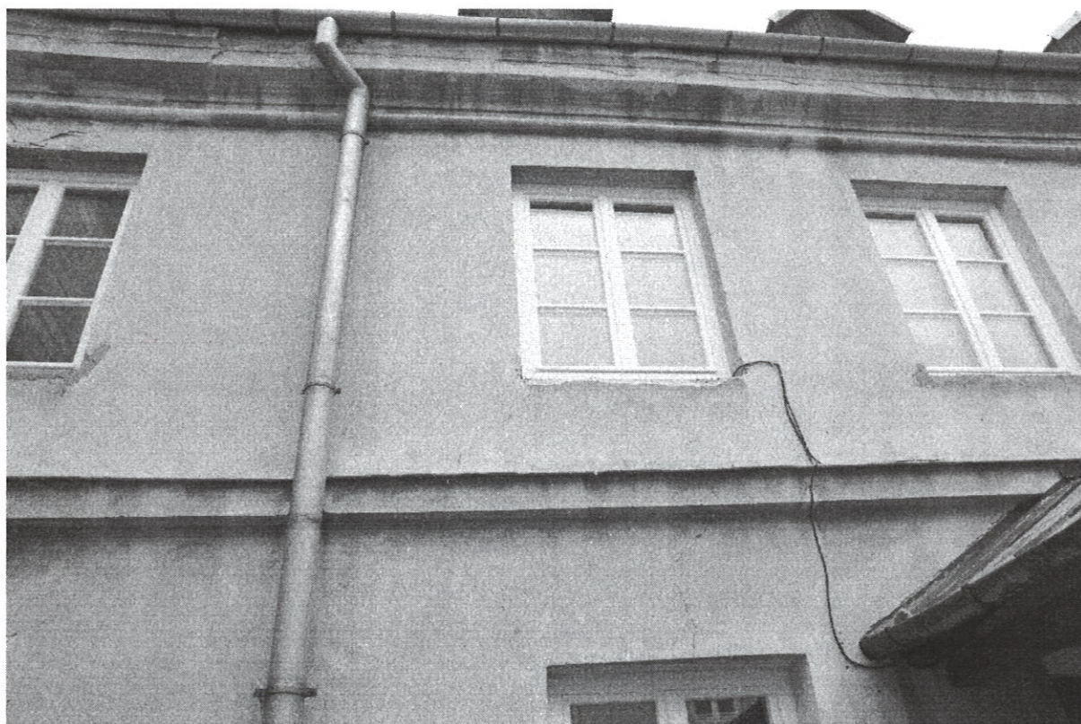
Fotografia 32. Zarysowanie ukośne przy otworze okiennym – nierównomierne osiadanie budynku;
