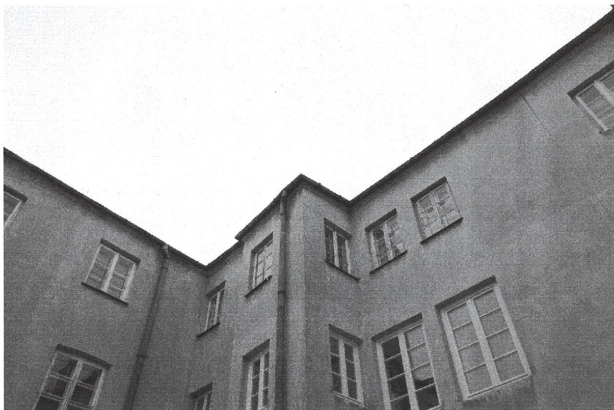
Fotografia 41. Zarysowanie poziome narożnika oraz destrukcja tynku w rejonie gzymsów i rynien.
