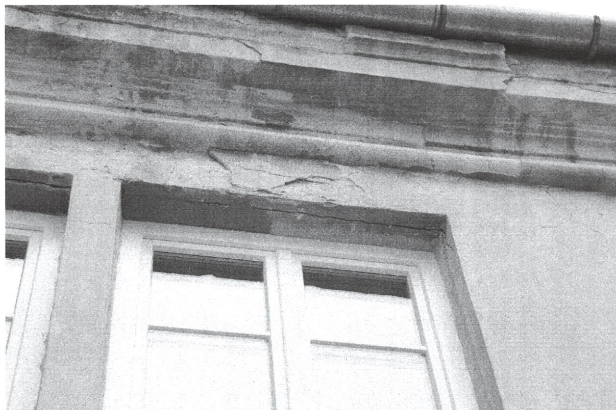
Fotografia 31. Odspojenie tynku nad otworami okiennymi – spowodowane zawilgoceniem gzymsu na skutek nieszczelności rynien. Ubytki tynku w rejonie gzymsu.
