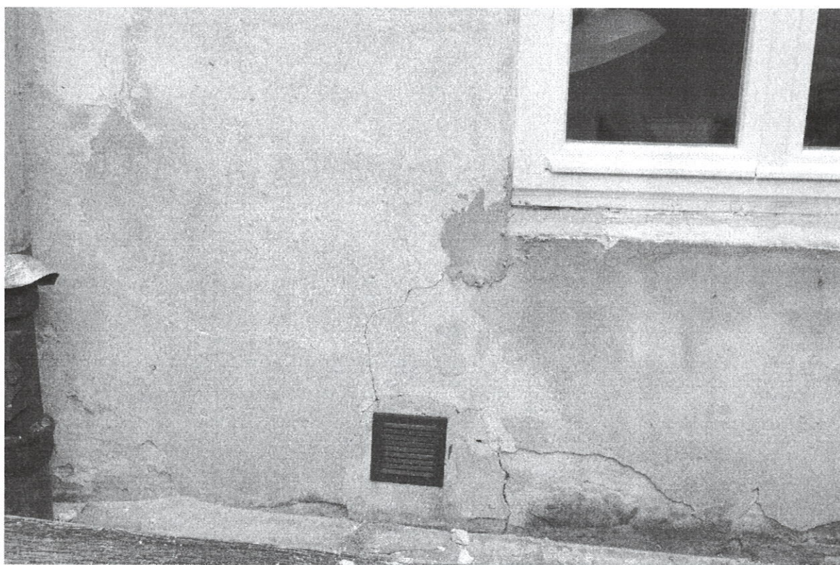
Fotografia 33. Zarysowanie ukośne przy otworze okiennym – nierównomierne osiadanie budynku;
