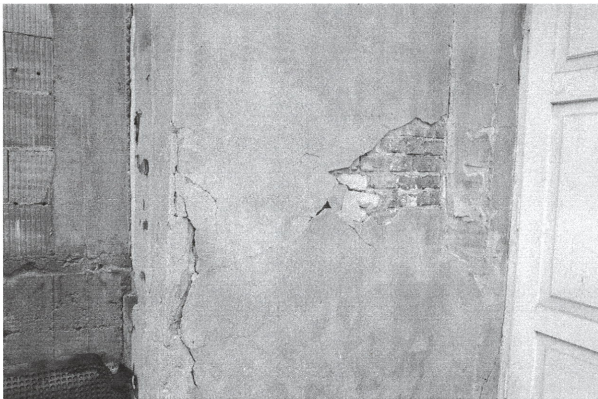
Fotografia 28. Szczeliny i zarysowania tynku budynku sąsiedniego.
