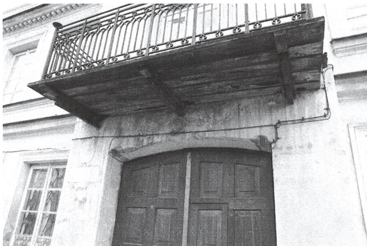
Fotografia 6. Uszkodzenia tynku w rejonie balkonu. Elementy stalowe skorodowane. Korozja biologiczna podłogi balkonu.
