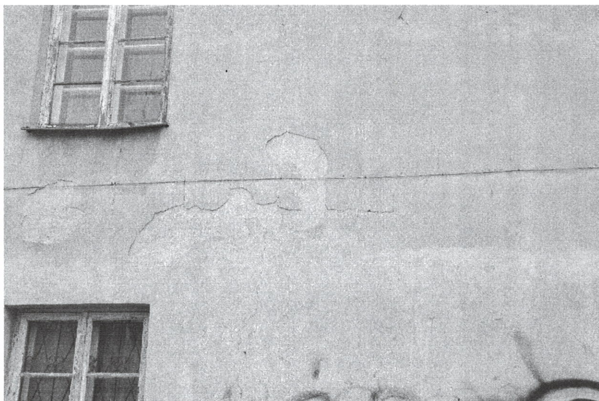
Fotografia 20. Ubytki tynku na elewacji południowej budynku.
