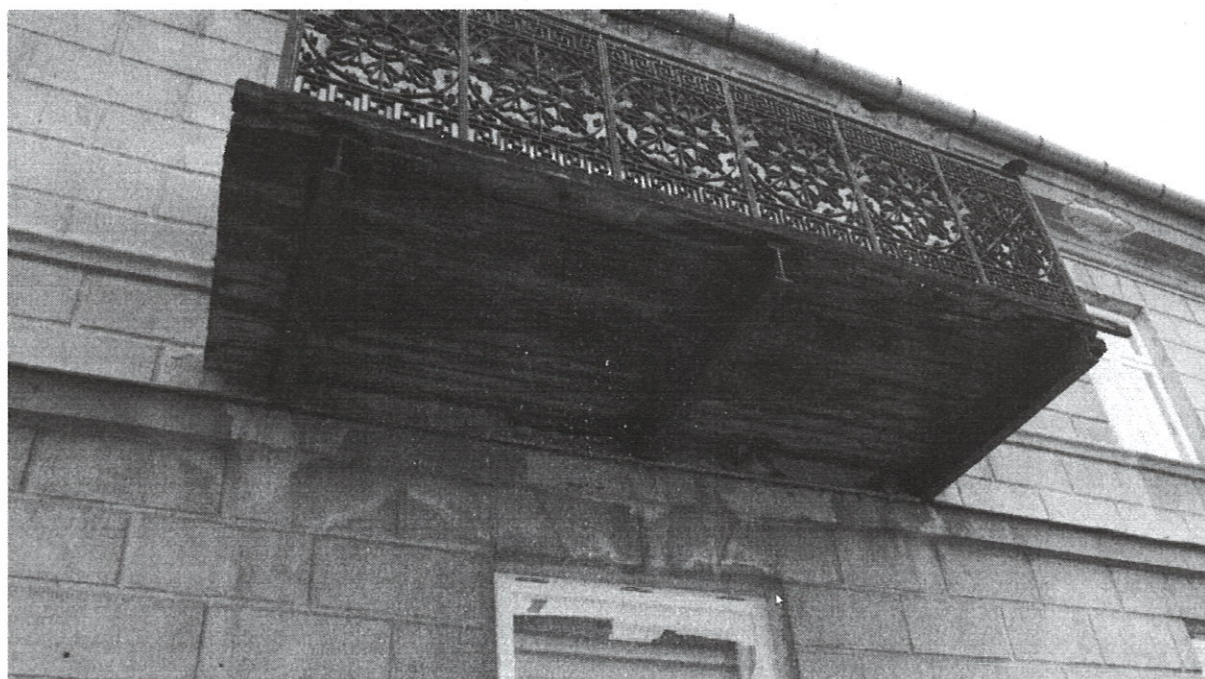
Fotografia 12. Uszkodzenia tynku w rejonie balkonu. Elementy stalowe skorodowane. Korozja biologiczna podłogi balkonu.
