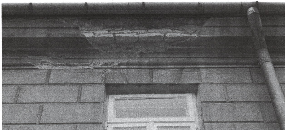
Fotografia 16. Ubytki tynku w rejonie gzymsu – nieszczelności obróbek blacharskich.
