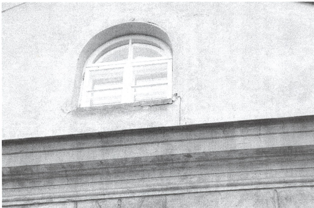
Fotografia 3. Rysy w rejonie otworu okiennego spowodowane brakiem obróbek blacharskich – parapetu. Rysy skurczowe tynku widoczne na gzymsie budynku.
