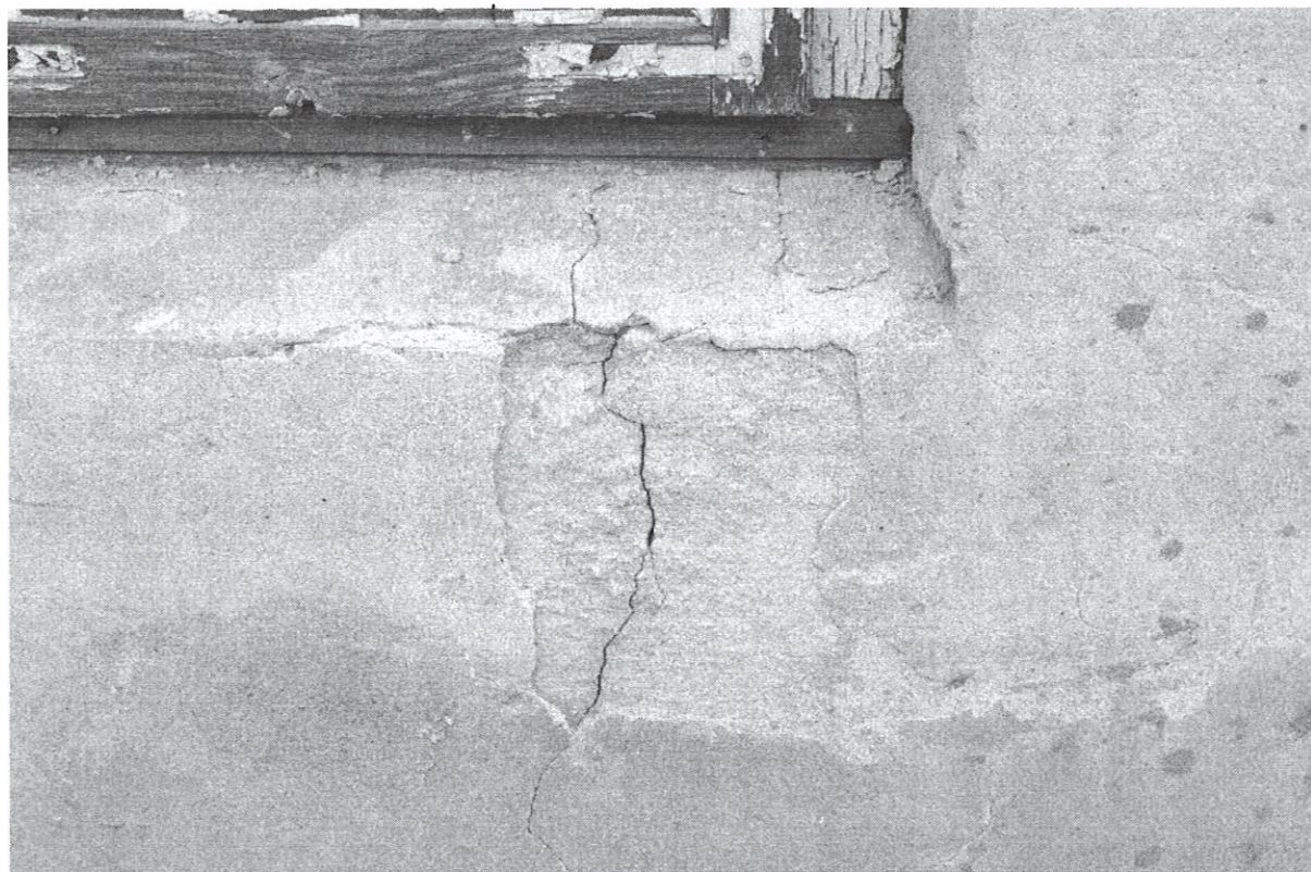
Fotografia 22. Brak parapetów zewnętrznych przy otworach okiennych. Zarysowanie spowodowane zawilgoceniem tynku.
