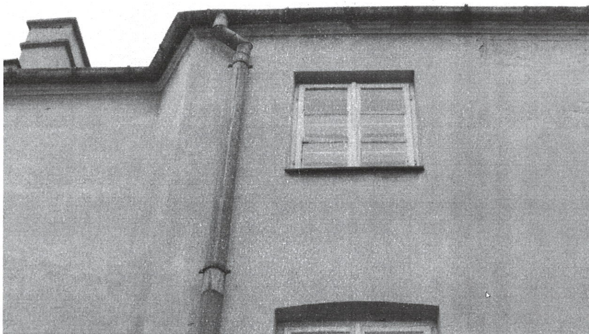
Fotografia 44. Zarysowania w rejonie otworów okiennych oraz destrukcja tynku gzymsów przy rynnach.
