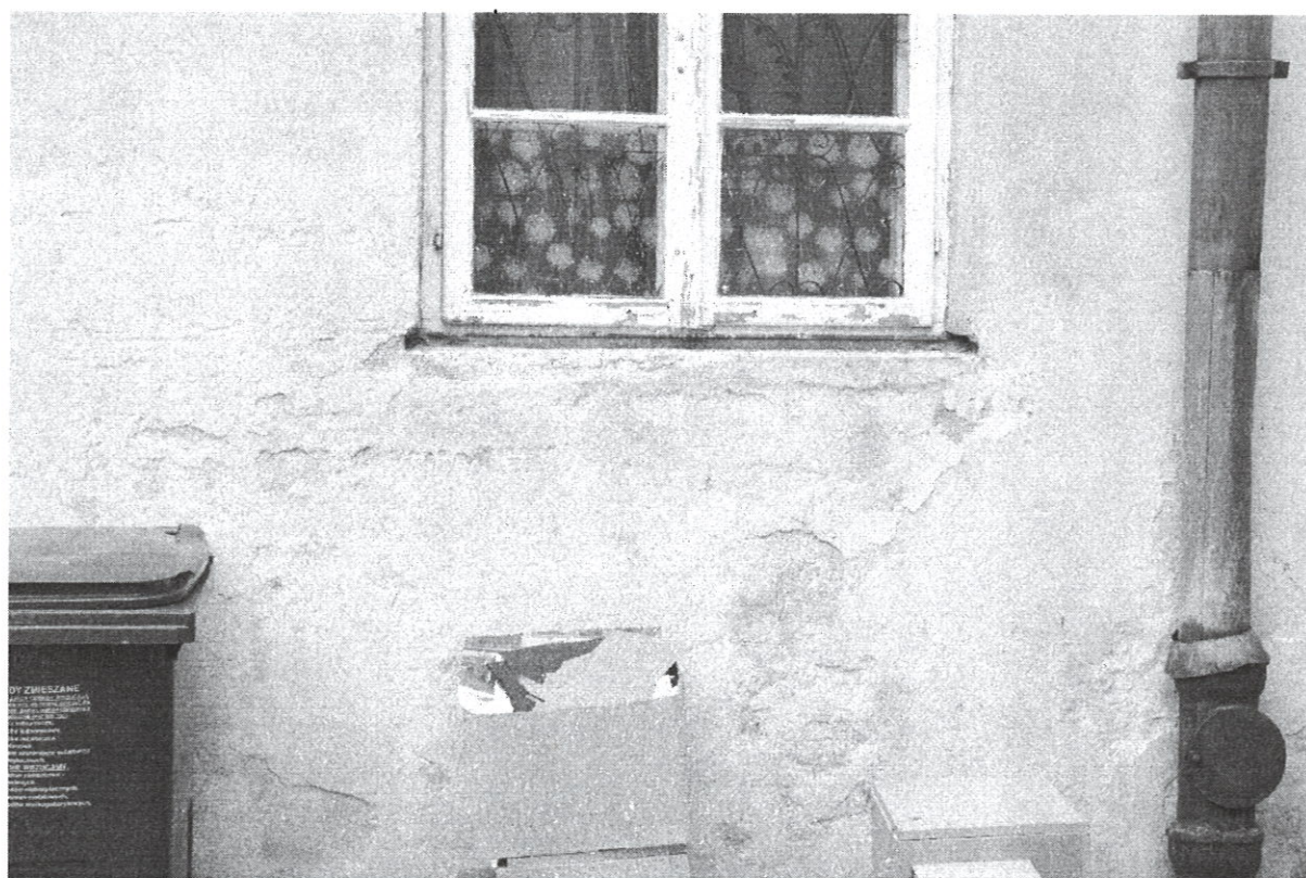
Fotografia 46. Uszkodzenia tynku w rejonie przyziemia spowodowane zawilgoceniem i zasoleniem. Rura spustowa w złym stanie technicznym.
