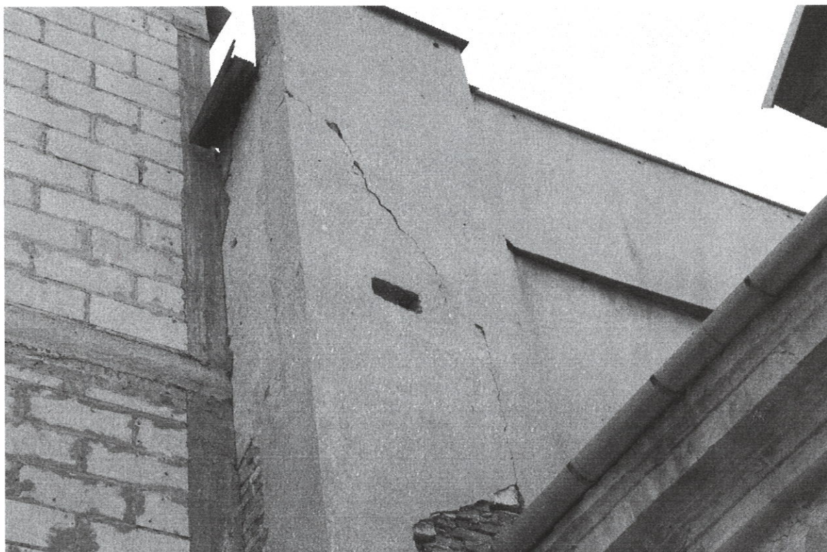
Fotografia 26. Destrukcja narożnika budynku sąsiedniego. Widoczne duże zarysowanie i ubytki tynku.
